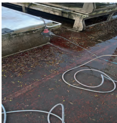
Wasser läuft ab
